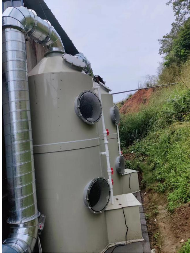
图 4-4 废气治理设施图
