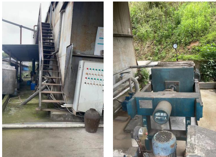
图 4-2 废水治理设施图
